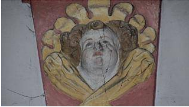
Von Rissen durchzogener Stuckkopf in der Kirche der Klosters in Schönau bei Gemünden. Foto: Michael Mahr
